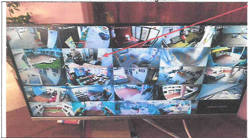
Imagen n.º 23 Monitor de Cámaras de Video Vigilancia
