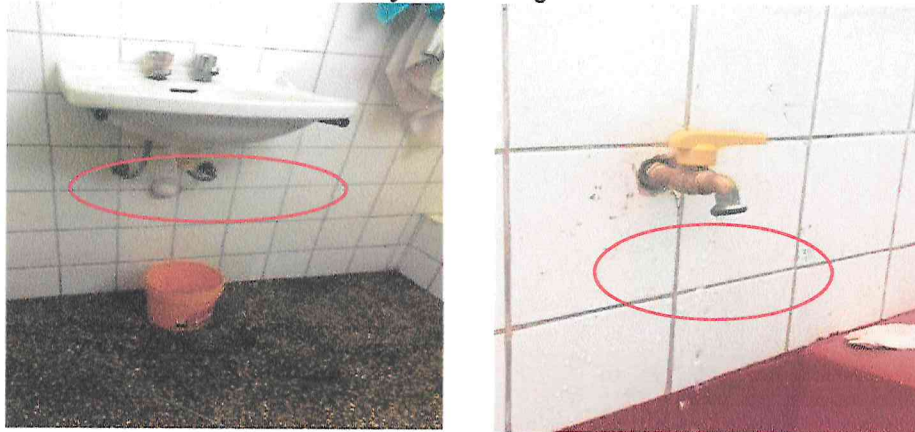
Imágenes n.ºs 1 y 2 Caños y tuberías malogradas
