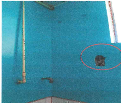
Imagen n.º 4 Instalación Eléctrica ubicada en el Servicio Higiénico
