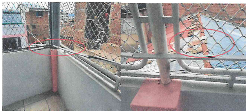
Imágenes n.ºs 5 y 6 Instalaciones Eléctricas en área de recreación
