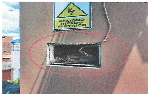
Imagen n.º 3 Instalación Eléctrica ubicada en la azotea
