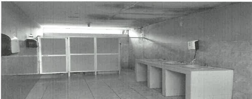
Fuente: Acta de inspección física al comedor universitario – Sede Satipo n.º 01-2023-UNCP/OCI-SVC-CU de 5 de julio de 2023. Elaborado por: Comisión de control
