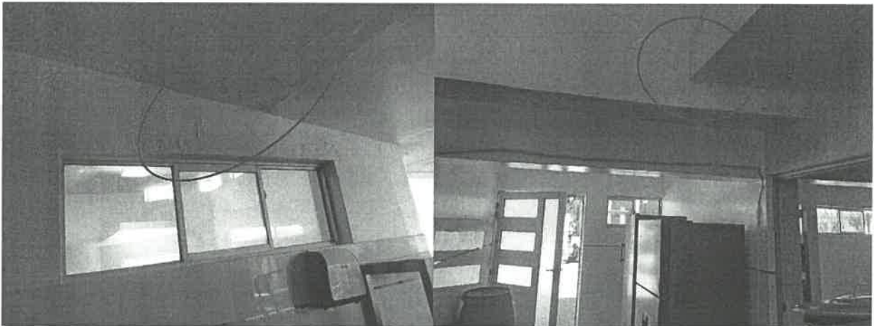
Fuente: Vista fotográfica del Área de Cocina, se visualiza filtraciones de agua en paredes y techos, día 3 de julio de 2023
