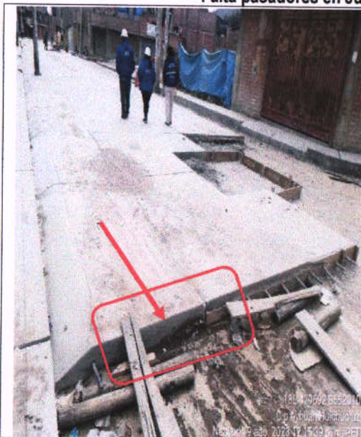
Figura n.º5: Se observa pasador de acero liso, no se encuentra en el concreto fraguado.
