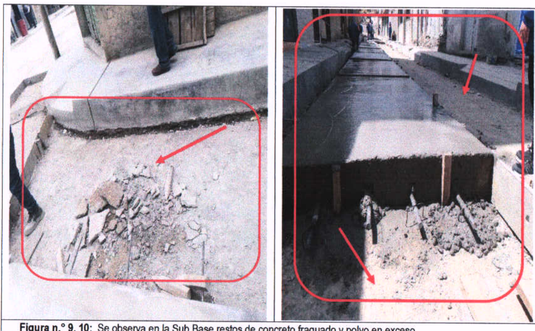
Figura n.º 9, 10: Se observa en la Sub Base restos de concreto fraguado y polvo en exceso
