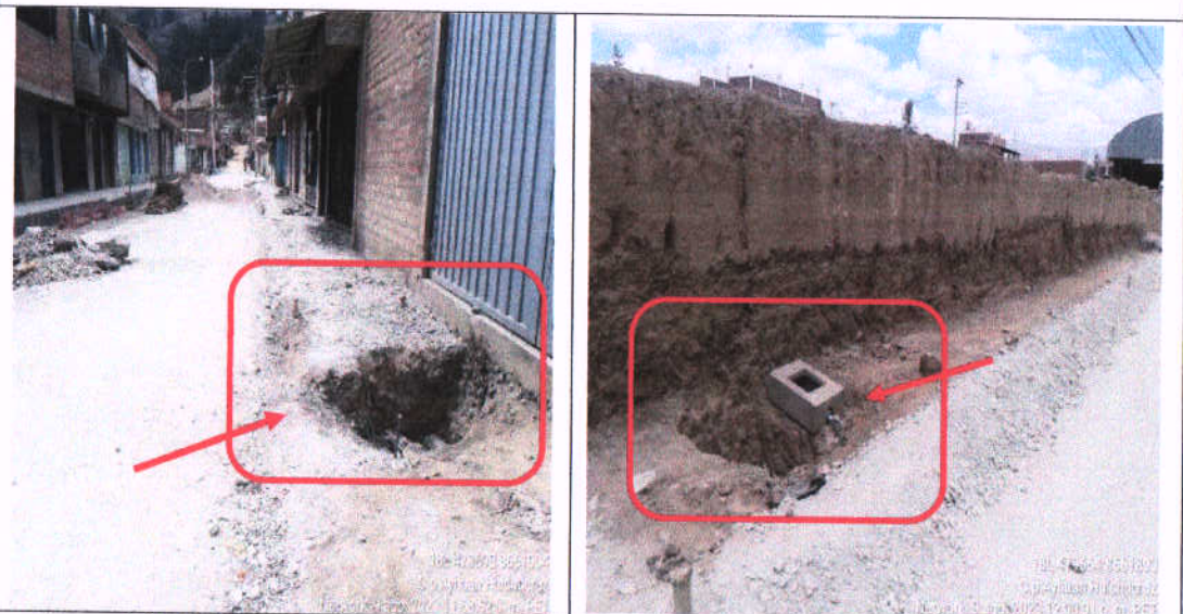
Figura n.º 13, 14: Se observa falta señalización en el Jr. Villa Azapampa.
