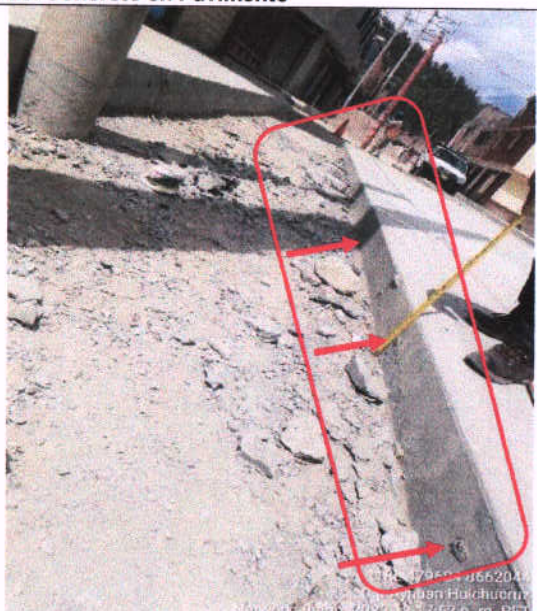
Figura n.º6: Se observa pasadores de acero corrugado, no se encuentran en el concreto fraguado.
