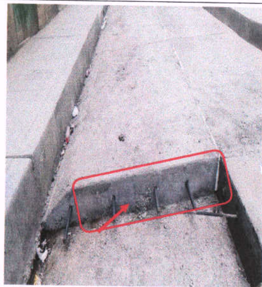
Figura n.º4: Se observa cangrejeras (vacíos) en el concreto de pavimento.
