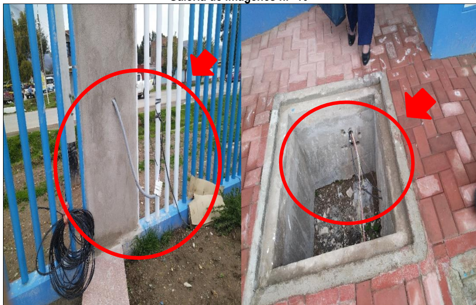
Imágenes n.ºs 21 y 22: Se muestra la acometida de energía eléctrica pública instalada de manera deficiente (presencia de cables eléctricos expuestos a la intemperie sin ningún tipo de aislamiento), asimismo, la falta de tapas de las cajas de registro que protejan las instalaciones eléctricas.
