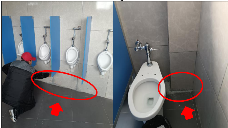
Imágenes n.ºs 11 y 12: Se muestra que los aparatos sanitarios tales como lavaderos ovalines de cerámico y urinarios de los servicios higiénicos se vienen desprendiendo debido a su inadecuada instalación; asimismo, se ha identificado fugas de agua en sus conexiones las cuales humedecen las paredes de dichos ambientes.
