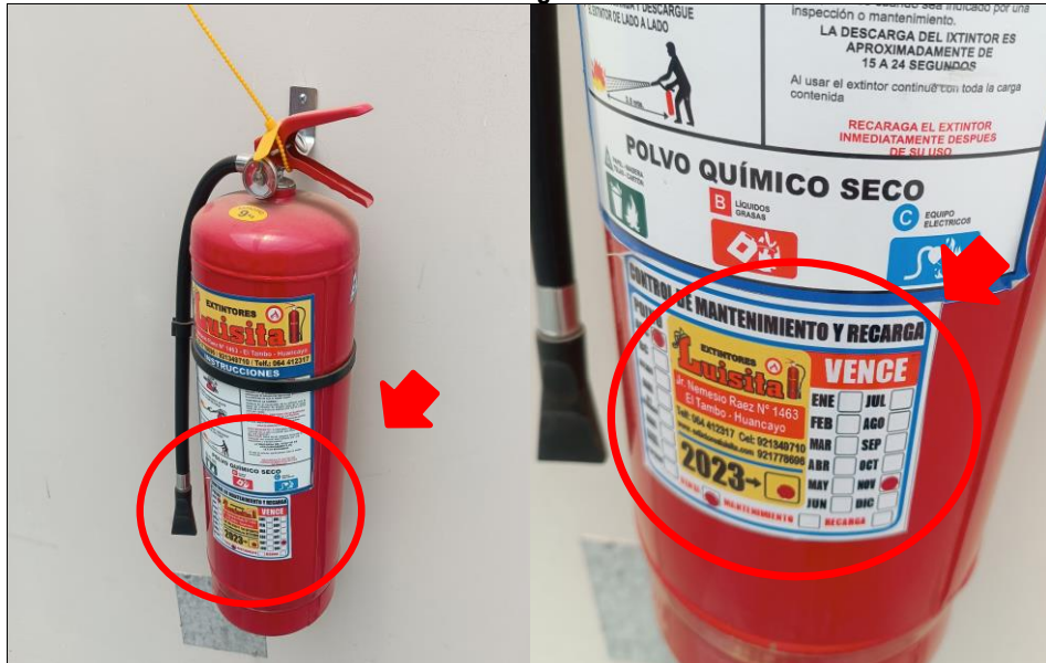
Imágenes n.ºs 23 y 24: Se muestra que todos los extintores del terminal terrestre se encuentran con fecha de caducidad vencidas (noviembre 2023).
