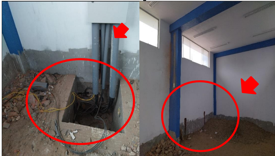
Imágenes n.ºs 19 y 20: Se muestra el ambiente destinado como subestación eléctrica y/o caseta de máquinas, la cual se encuentra inconclusa, presentando tuberías y cables expuestos, así como la falta del acabo del falso piso.
