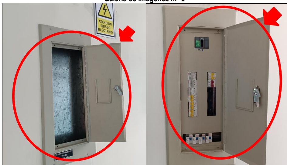
Imágenes n.ºs 17 y 18: Se muestra que en algunos tableros de distribución eléctrica de la infraestructura no se ha instalado accesorios ni el cableado correspondiente; asimismo, en otros casos donde si se han instalado dichos accesorios, los tableros no cuentan con señaléticas de seguridad.
