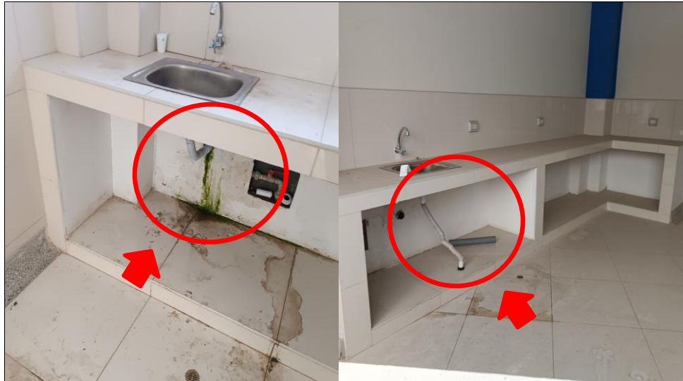
Imágenes n.ºs 7, 8, 9 y 10: Se muestra los lavaderos metálicos de los módulos del patio de comidas los cuales se vienen desprendiendo debido a su inadecuada instalación; asimismo, se ha identificado fugas de agua en las trampas de dichos lavaderos.
